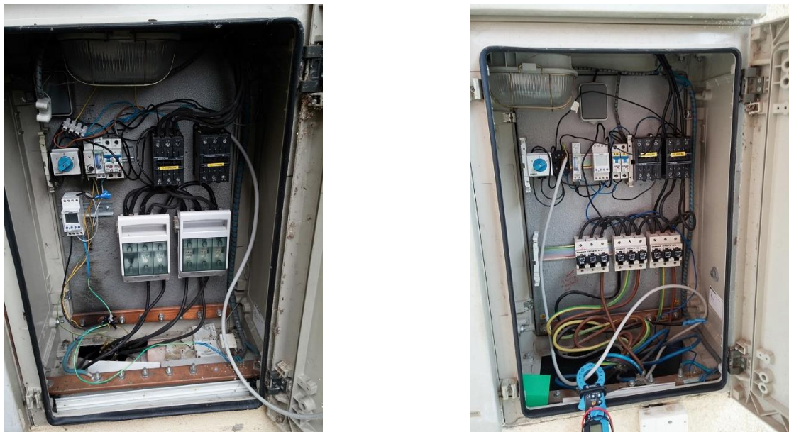
Slika 9. Prikaz zatečenog stanja razvodnih ormara
